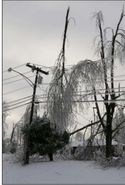
2009 Daños por tormenta de hielo. Foto cortesía del sitio web de NWS Paducah
